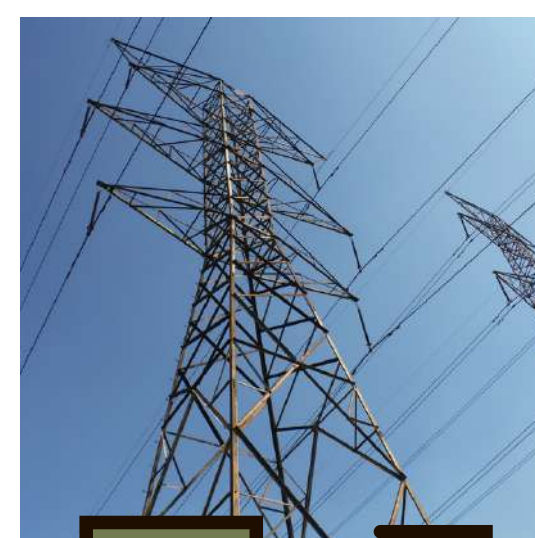
ABASTECIDO DE ENERGIA ELÉTRICA
